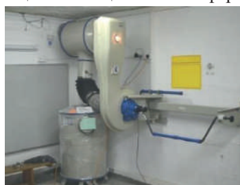
Іл. 28.5. Фільтровентиляційний агрегат
