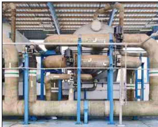
Рис. 57. Піщані фільтри головного заводу в Thuwal на узбережжі Червоного моря, Саудівська Аравія
